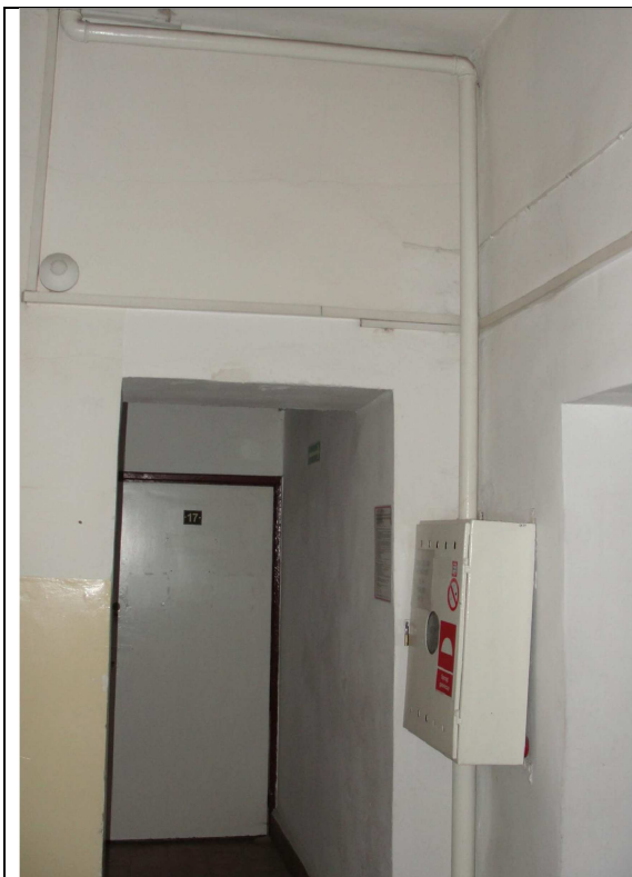
Fot.13. Boczna klatka schodowa - istniejący hydrant.
